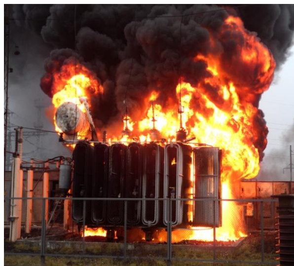
Рис. 43. Пожар на подстанции
