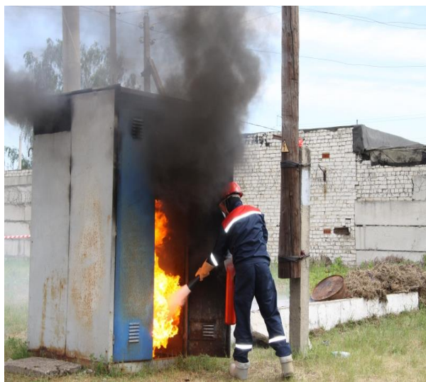
Рис. 42. Пожар в электрическом щите
