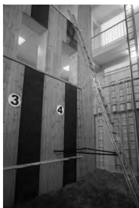
Рис. 5. Общий вид смонтированного устройства
