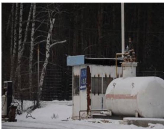
Рис. 3. АГЗС - несоблюдение противопожарных расстояний, г. Воронеж, Московский проспект
