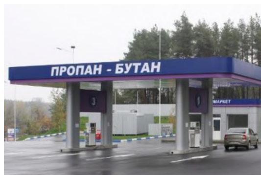
Рис. 2. АГЗС - несоблюдение противопожарных расстояний, г. Воронеж, ул. 9 января
