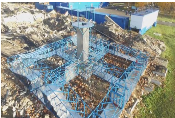
Рис. 1. Многофункциональный модульный тренажерный комплекс подготовки пожарных и спасателей к работе в условиях ограниченного пространства «Диггер»
