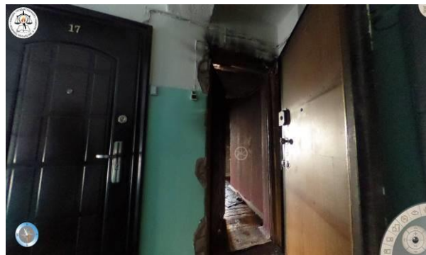
Рис. 4. Результат визуализации сгоревшей квартиры в многоквартирном доме – вход
