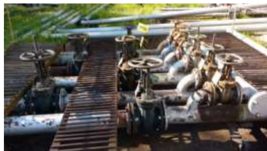
Рис. 2. Участок нефтепродуктопроводов с запорной арматурой, требующей замены уплотнителей фланцевых соединений
