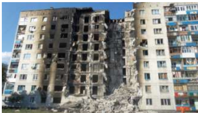
Рис. 5. Фото частично разрушенного и сгоревшего панельного 9-ти этажного дома, Донецк [12]
