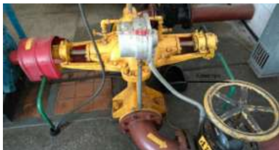
Рис. 1. Сбор капельной утечки через фланцевое соединение бензина в канистру
