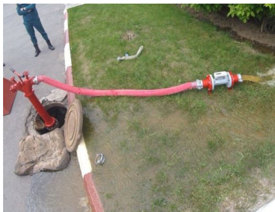
Рис. 5. Работа расходомера на водоотдачу
