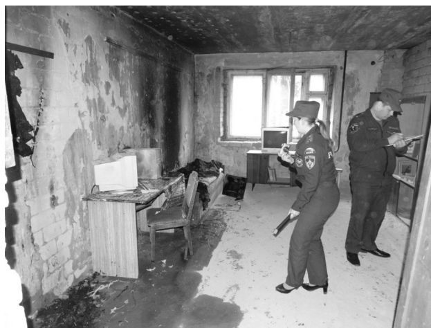
Рис. 2. Фрагмент комнаты после пожара
