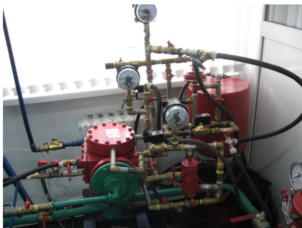
Рис. 1. Внешний вид узла управления экспериментальной установки автоматического водяного пожаротушения
