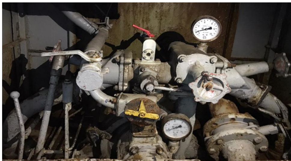
Рис. 1. Насос центробежный пожарный
