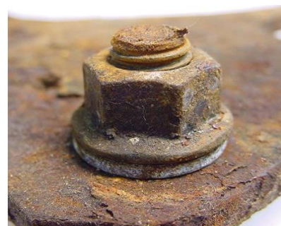
Рисунок. Коррозия резьбового соединения элемента подвески пожарного автомобиля
