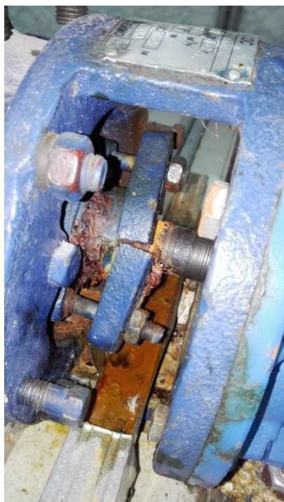
Рис. 1. Нарушение устройства уплотнения в центробежном консольно-моноблочном насосе
