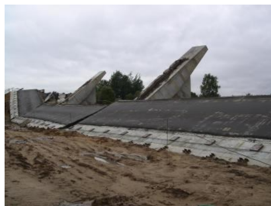
Рис. 2. Фотография с места разрушения моста
