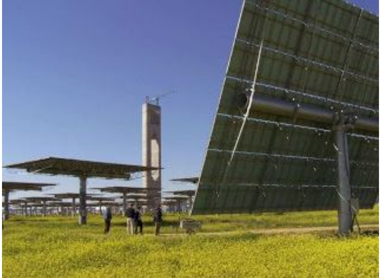
Рис. 1. Солнечная электростанция башенного типа
