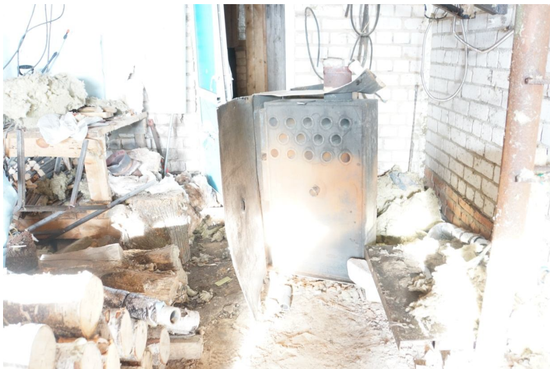
Рисунок. Разрушения отопительного котла на твердом топливе
