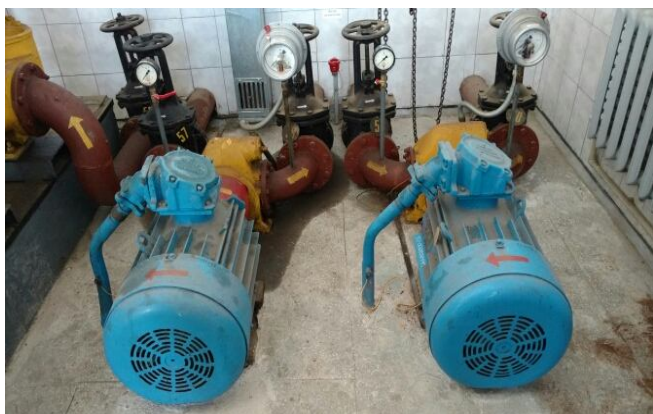
Рис. 2. Капельная утечка дизельного топлива через уплотнительные кольца фланцевых соединений насоса БНДв-Б
