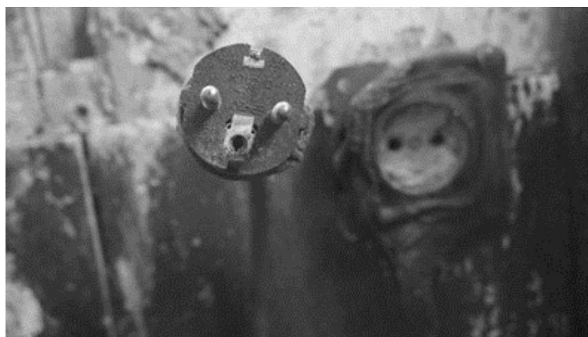
Рис. 3. Фото вилки соединительного кабеля электродвигателя насосной станции
