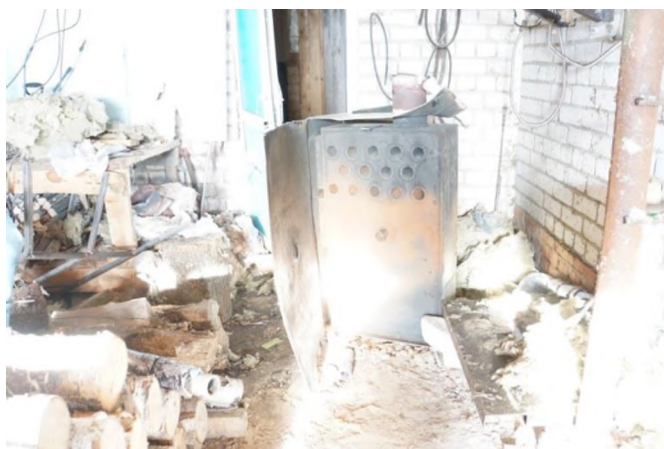
Рисунок. Пример разрушения отопительного котла на твердом топливе
