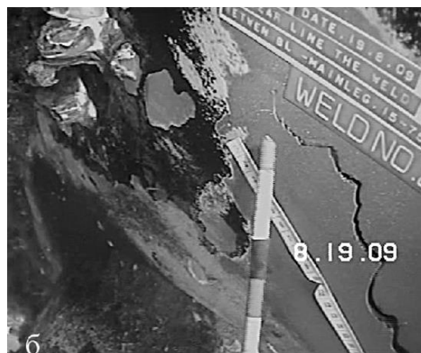
Рис. 1. Трещина, обнаруженная в ходе обследования морской платформы
