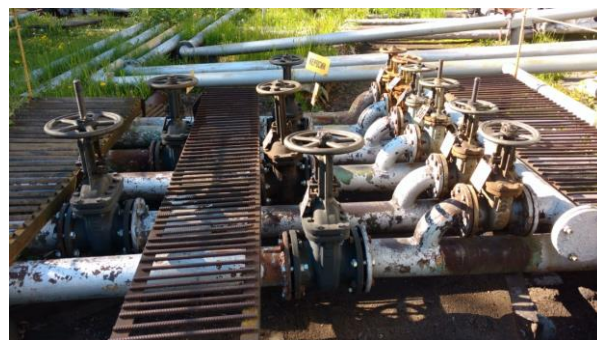
Рис. 2. Участок трубопроводной арматуры на линиях транспортировки нефтепродуктов в резервуары. Трубопроводы диаметром DN-200, PN-16, с задвижками клиновыми ручными ЗКЛ 30с41нж
